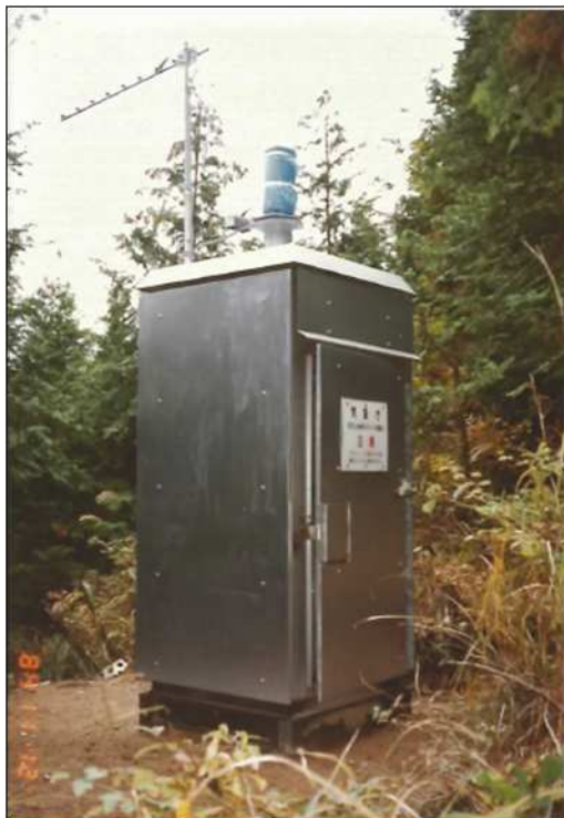
笠形山無線ロボット雨量観測所 (昭和 59 年 11 月 12 日撮影)
