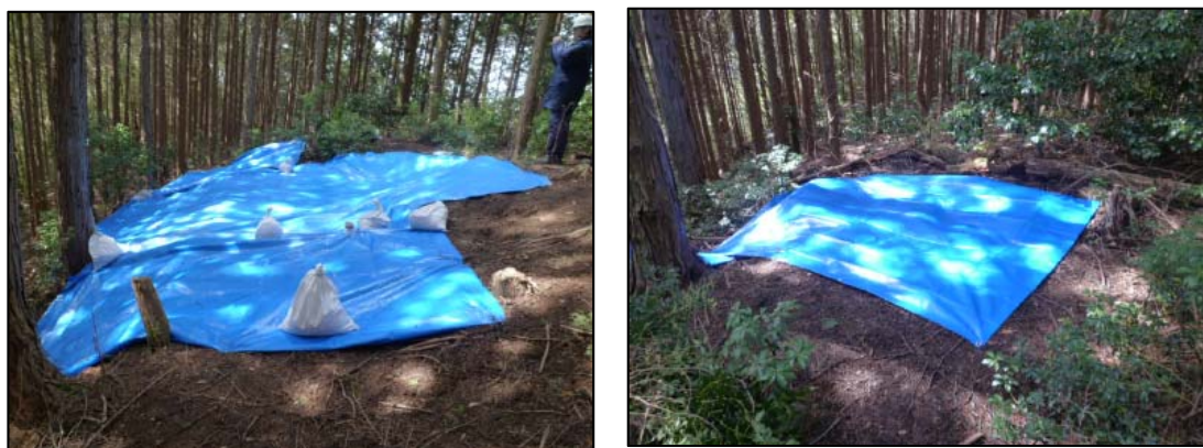
図4：飛散等の防止のためのブルーシートによる応急処置の状況
