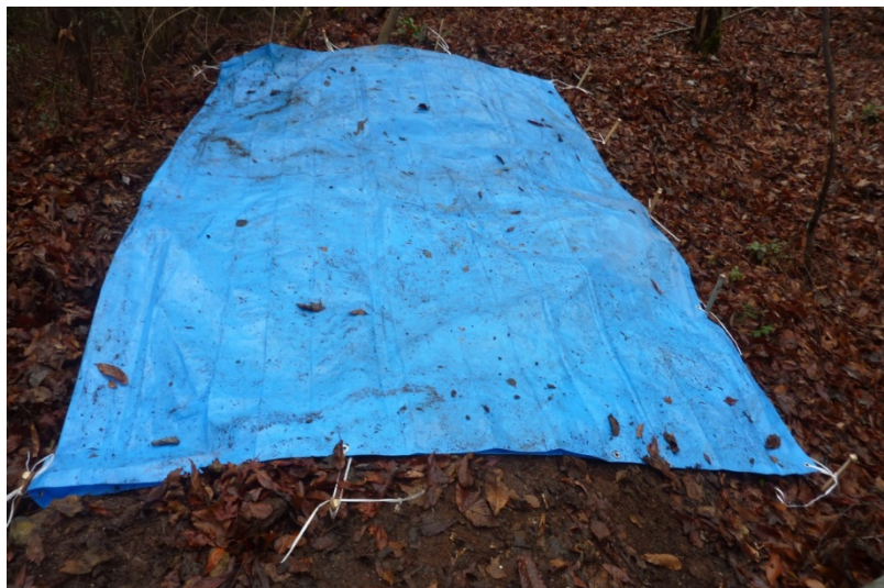
図3：飛散防止のためのブルーシートによる応急処置の状況
